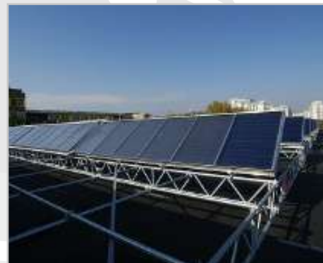
ACS Y CLIMATIZACIÓN ALBERCA pabellón deportivo
