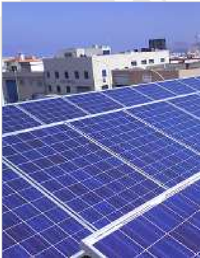
Cubierta Solar 50kW
