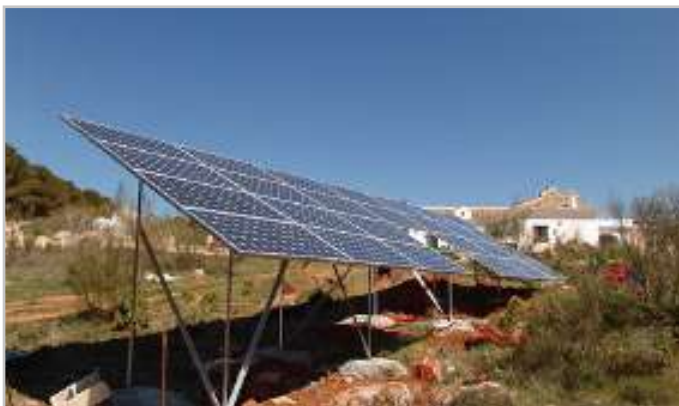
Inst. Fotovoltaica Aislada 5kW
