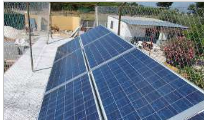
st. Fotovoltaica Aislada 1kW
