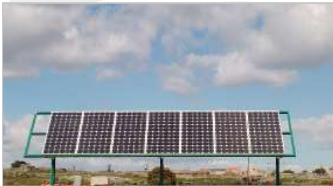
Inst. Fotovoltaica Aislada 1kW
