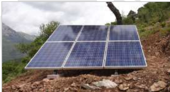
Inst. Fotovoltaica Aislada 1,5kW
