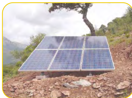
Inst. Fotovoltaica Aislada 1,5kW
