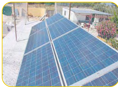
Inst. Fotovoltaica Aislada 1kW
