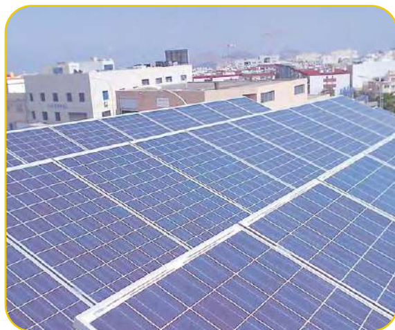
Cubierta Solar 50kW
