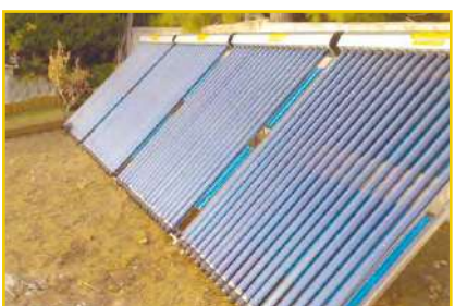
Instalación con tubos de vacío
