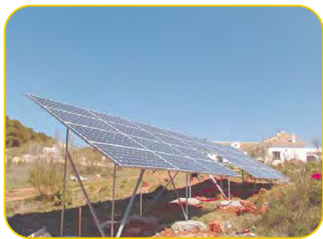
Inst. Fotovoltaica Aislada 5kW
