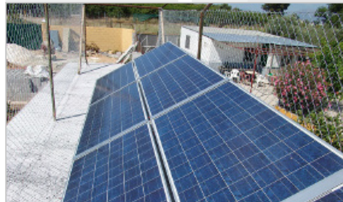
st. Fotovoltaica Aislada 1kW
