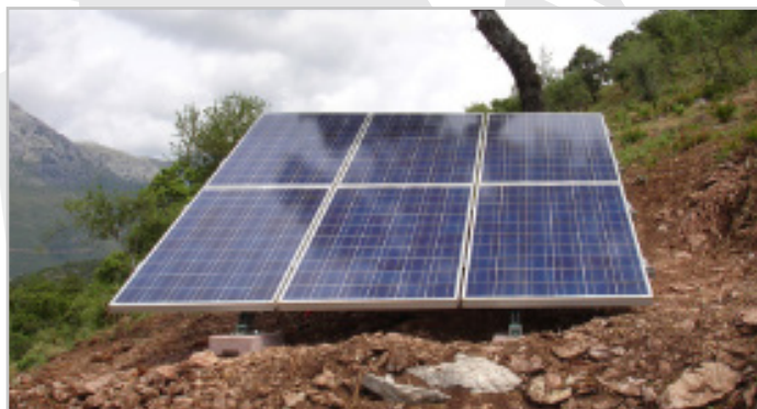
Inst. Fotovoltaica Aislada 1,5kW
