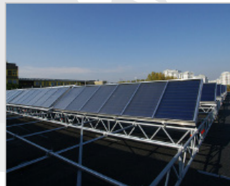
ACS Y CLIMATIZACIÓN ALBERCA pabellón deportivo
