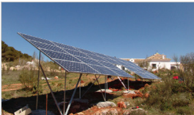
Inst. Fotovoltaica Aislada 5kW
