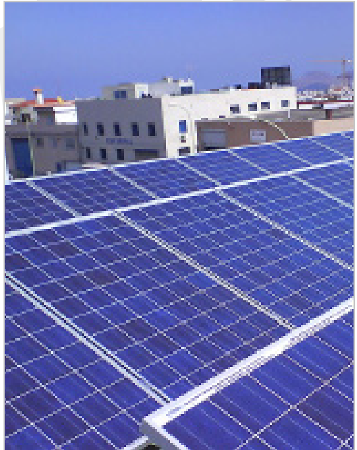
Cubierta Solar 50kW
