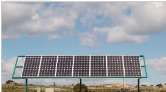
Inst. Fotovoltaica Aislada 1kW
