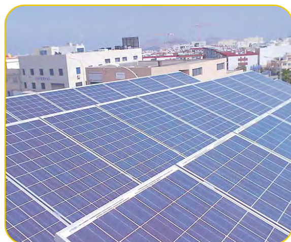
Cubierta Solar 50kW
