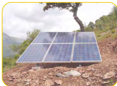
Inst. Fotovoltaica Aislada 1,5kW
