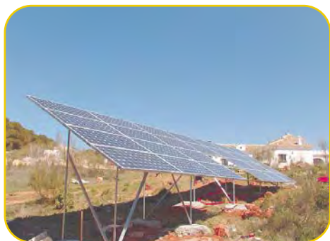
Inst. Fotovoltaica Aislada 5kW
