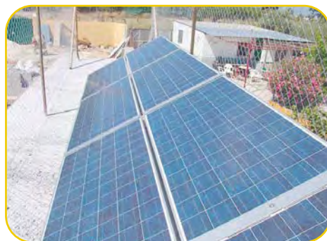
Inst. Fotovoltaica Aislada 1kW
