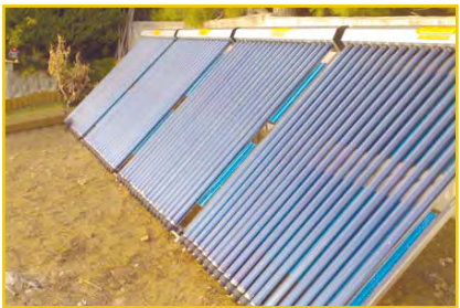
Instalación con tubos de vacío
