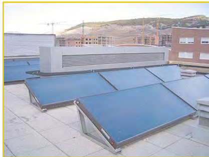
Instalación con paneles planos
