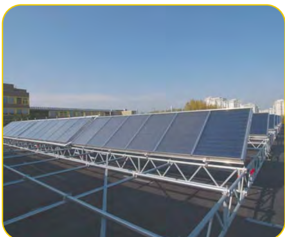
ACS y CLIMATIZACIÓN PISCINA pabellón deportivo
